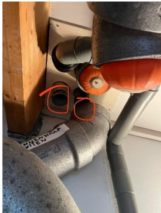
Afbeelding 14. Leidingen van het oude systeem vergeten af te dichten
