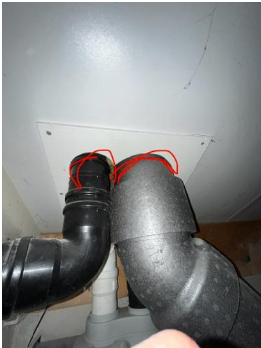
Afbeelding 13. Kieren rondom verwarmde leiding
