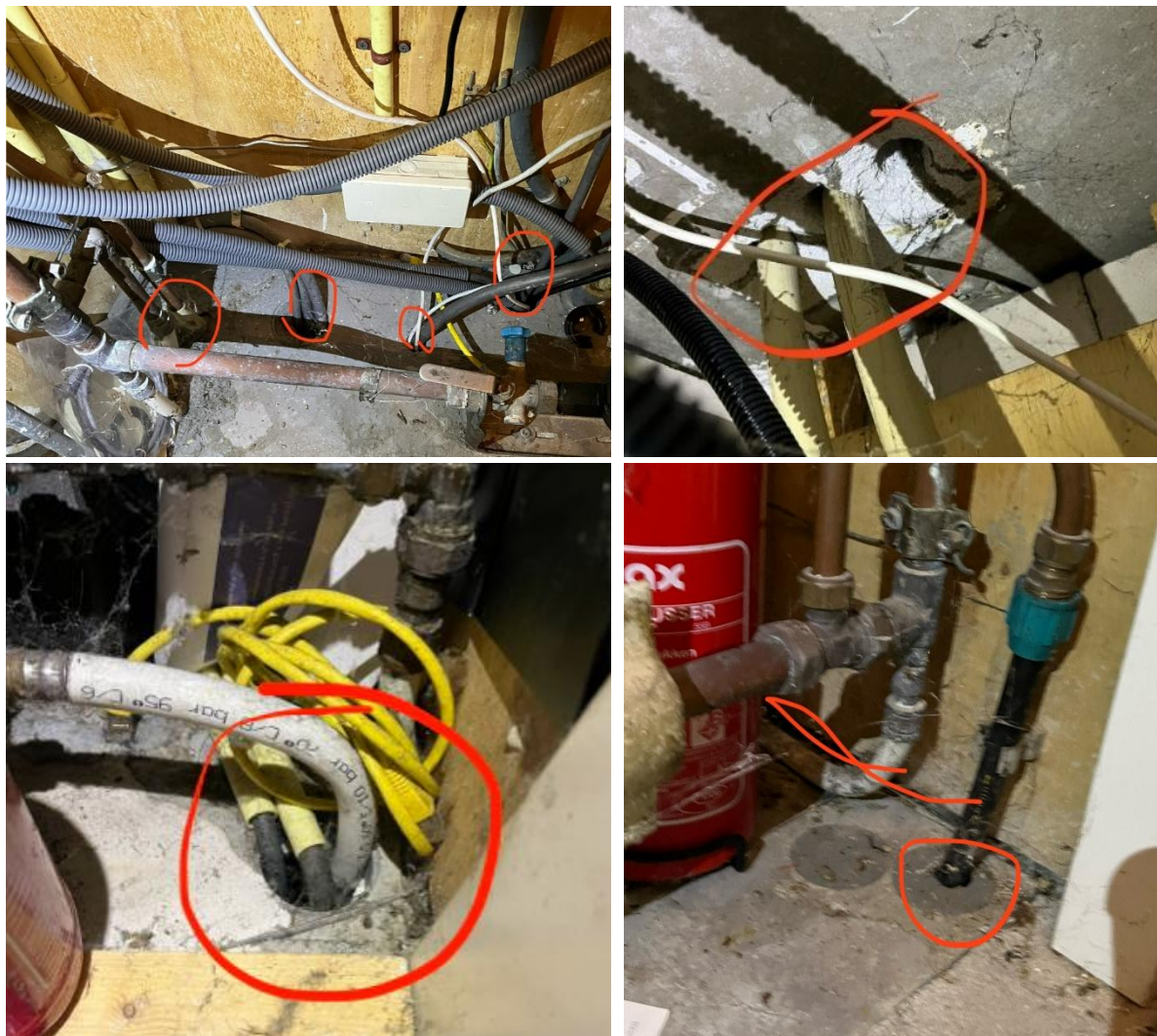
Hierboven zijn verschillende soorten kieren in de meterkast met rood aangegeven
