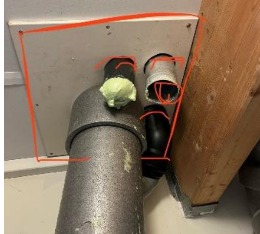
Afbeelding 12 Loze leiding en kieren rond bestaande leidingen
