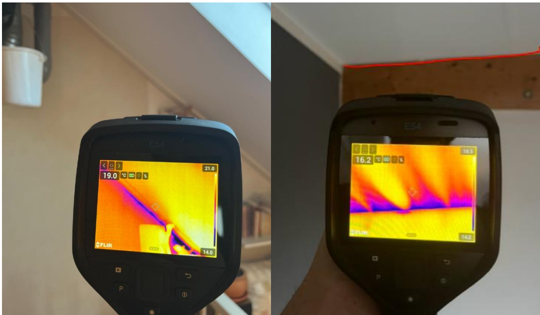
Afbeelding 6: Veelvoorkomende kier tussen aansluiting dak en muur
